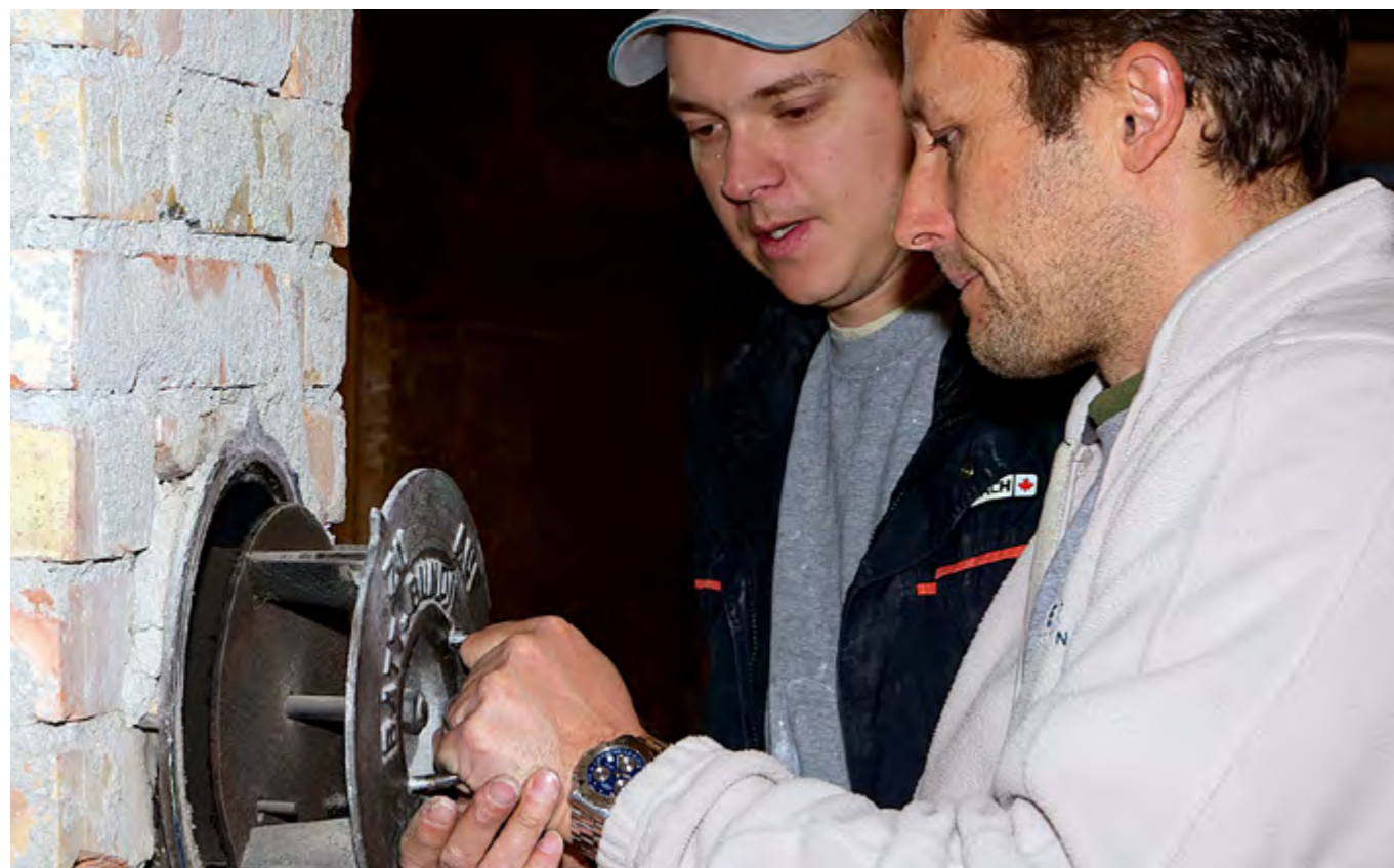
Der neue Drehschieber ist ein gebrauchtes Stück, wie es sich für ein historisches Haus gehört.
